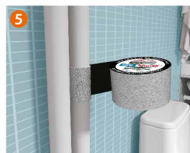
Tuyaux d'installation sanitaire
