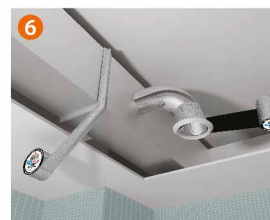
Canaux de ventilation
