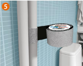
Sihi tesisat borularında
