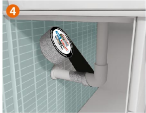
Lavabo çıkış borularında
